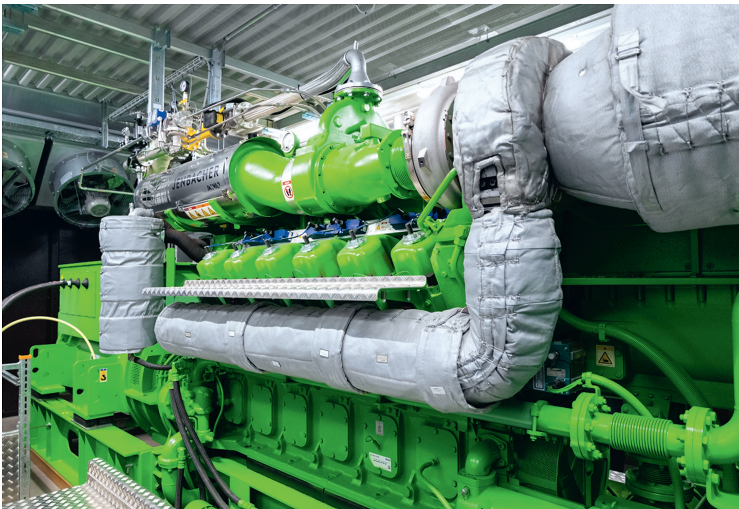
Die zwei jüngst installierten gasbetriebenen Blockheizkraftwerke (BHKW) sind Teil eines Gesamtkonzepts einer sicheren kommunalen Energieversorgung, die in der Fernwärmezentrale Lukasmühle zum Tragen kommt.
