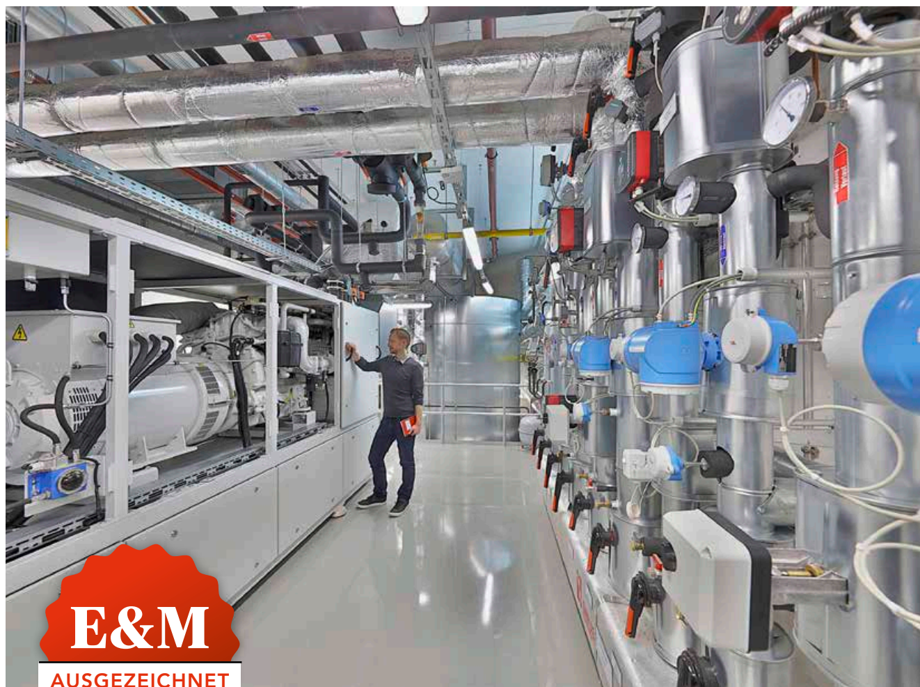
Blockheizkraftwerk und Warmwasserspeicher im Keller des Fraunhofer IISB: Die Kraft-Wärme-Kopplungsanlage wurde im Rahmen des Erweiterungsbaus B in die Infrastruktur des Instituts integriert. Dort wird sie sowohl zur Wärme- und Stromversorgung als auch zu Forschungszwecken genutzt
